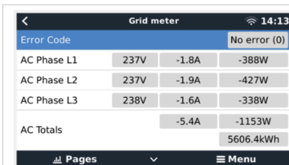
Detaillierte Übersichtsseite eines dreiphasigen Netzzählers
